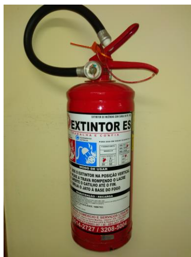
Extintor de 4 Kgs 2 Piso
