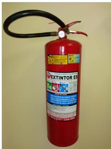
Extintor de Kgs 3 Piso
