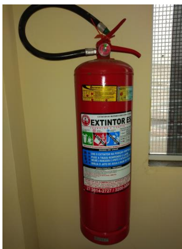
Extintor de 10 Kgs Auditório
