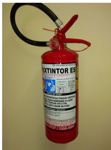
Extintor de 4 Kgs 3 Piso
