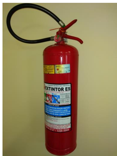
Extintor de 10 Kgs 1 Piso
